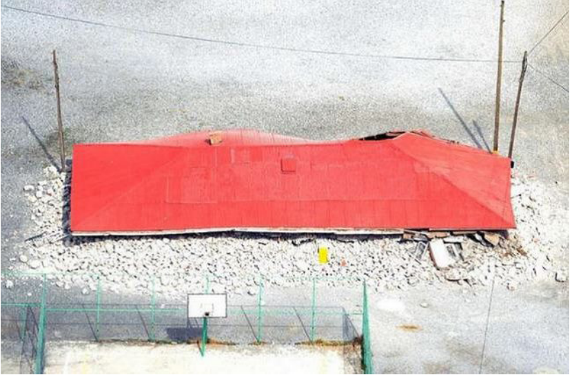
Fotoęraf 6: Yıkılan Okul Binası
