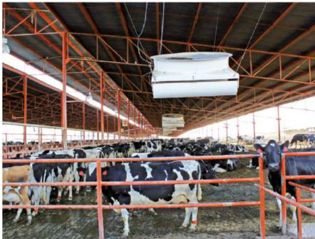
Figura 6.11: Currais com ventiladores instalados no teto (ventilação forçada). Fonte: Acervo pessoal do autor.
