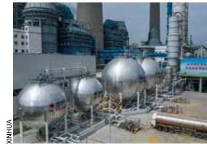
Tanques de dióxido de carbono.
