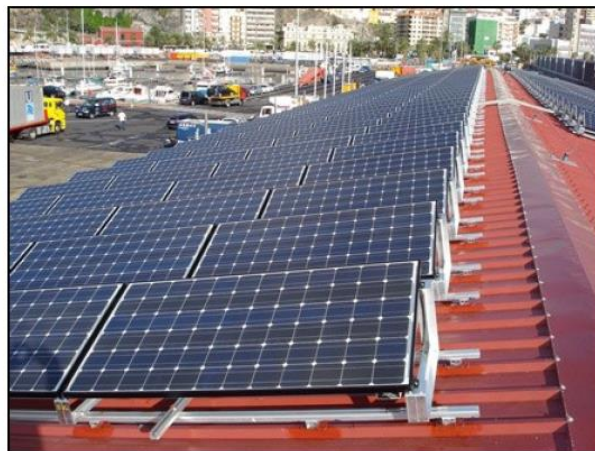
Figura 16. Paneles fotovoltaicos Puerto de Santa Cruz de La Palma (España)
